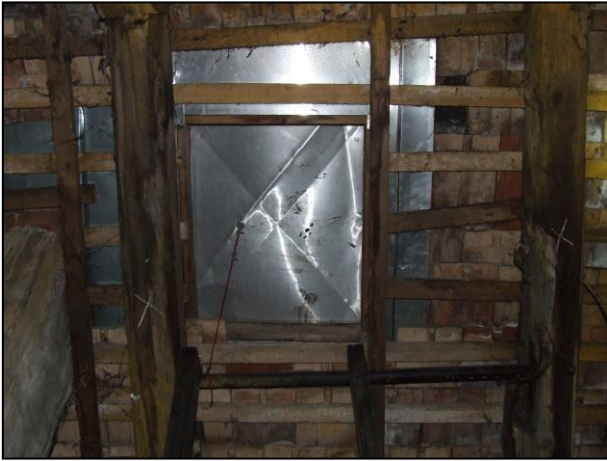
13. Rosszul záródó tetőkibúvó
