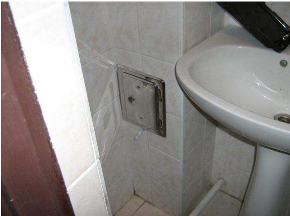
Beépített kamin ajtó
